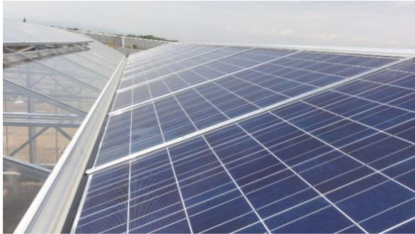
Serres photovoltaïque SAINT LAURENT D'AIGOUZE (30) Puissance électrique : 4.4 MWc Mise en service : Décembre 2011
